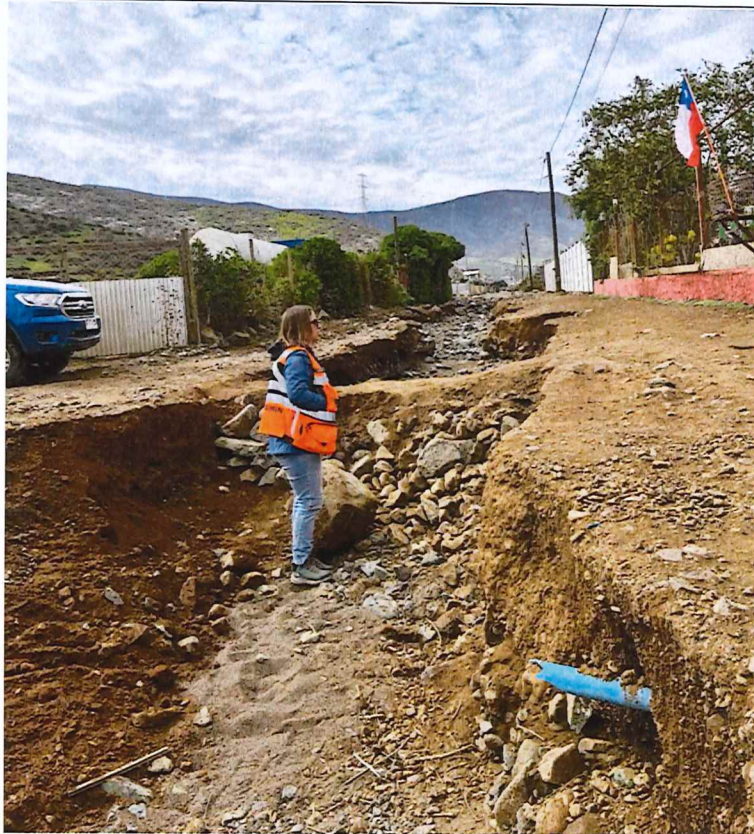
Erosión en torno a 1 m en calle Los Tiuques. Figura F Reporte Técnico Sernageomin
