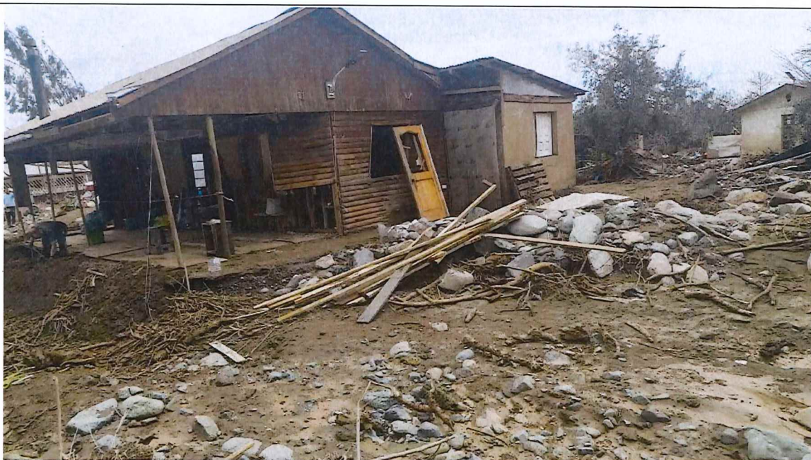
Foto evidencia vivienda destruida Pueblo El Islón. Evaluada por profesionales del MINVU al aplicar Ficha 2. Fecha 01 de septiembre de 2026
