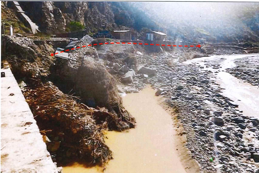
Fotografía vista hacia el norte, línea segmentada muestra sector donde se rompió la contención de gaviones, dejando expuestas viviendas de arrieros ubicadas en la ribera oeste del Estero Santa Gracia.
